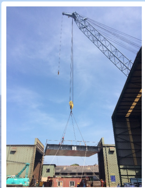
完成したブロックをクレーンで吊り上げて建造ドックへ!!
